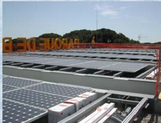
CONIL DE LA FRONTERA 50 kW
